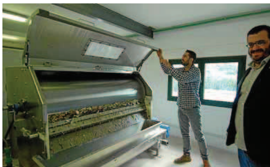
Depósitos e instalaciones de la depuradora. ● FOTO GEMMA ANDREU
